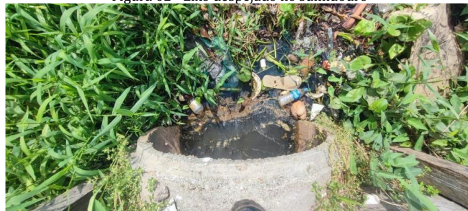
Figura 02 - Lixo despejado no sumidouro
