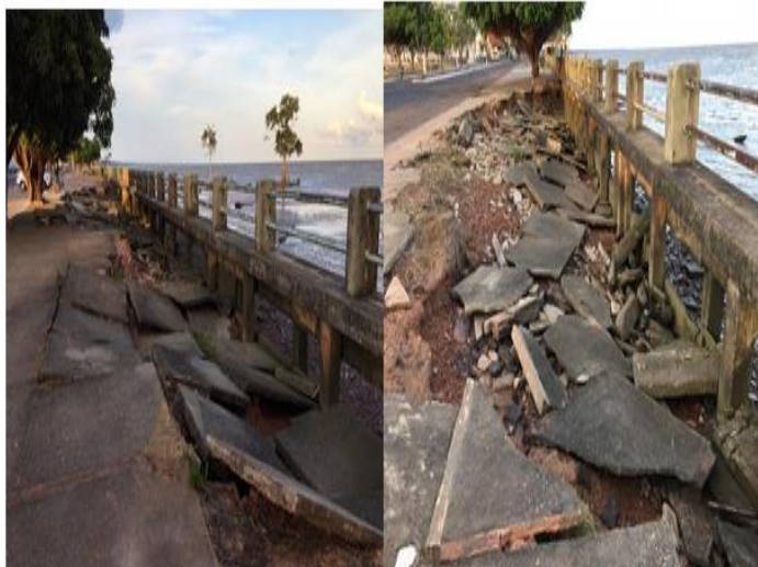
Figura 13 - Destruição do muro de arrimo da Orla do Perpétuo Socorro
